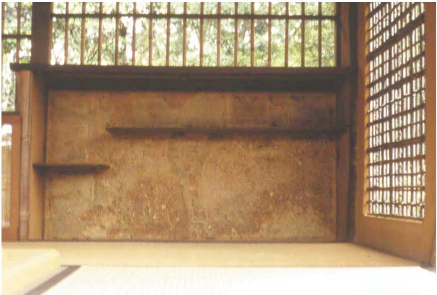
Pavillon de thé Shôka-tei (construit vers 1620). Mur de pisé et trame de bambou qui évoquent l'architecture rustique, à l'intérieur de la Villa impériale de Katsura, Kyôto
